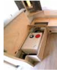
Der 47 Liter fassende Frischwassertank ist gut erreichbar in der Sitztruhe eingebaut
