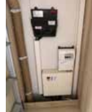
Perfekte zugängliche Elektrozentrale im Kleiderschrank
